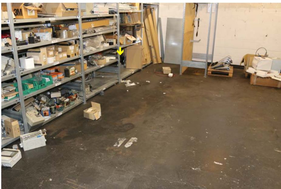
Abb. 2: Blick in die ehem. Kunststoffabteilung (heute Magazin). In dem dunkel verfärbten Teil (gelber Pfeil) ist der Gussasphaltpoden angelöst.
