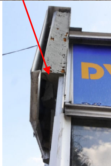
Abbildung 6: Blick auf die Nordfassade (Bild oben). Potentielle Einschupfmöglichkeit im Dachbereich; jedoch ohne Hinweise auf eine derzeitige Nutzung durch planungsrelevante Tierarten (Bild unten). (Fotos: BG Natur)
