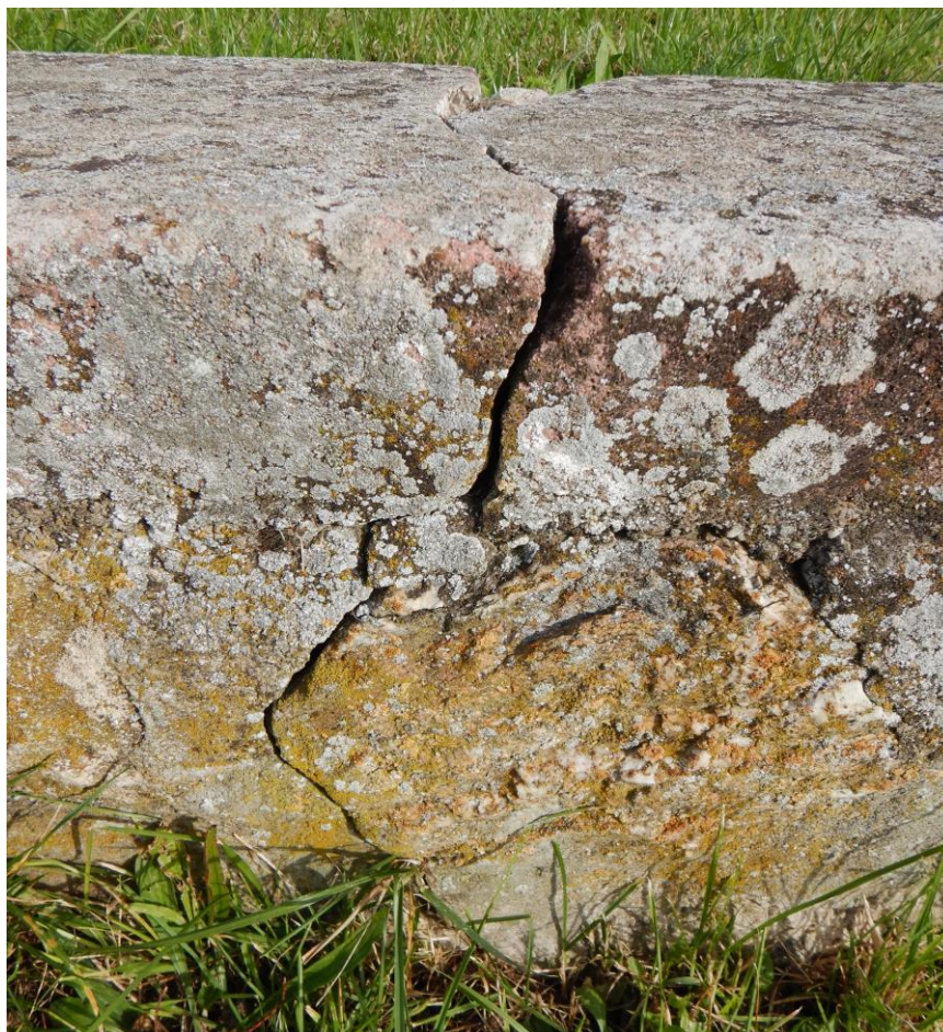
Abbildung 10: Aspekt der Mauer an der Straße „Am Reichsritterstift“ aus südwestlicher Richtung – Nahaufnahme der Fugen, vereinzelte Spalten vorhanden [Foto: BGNatur].
