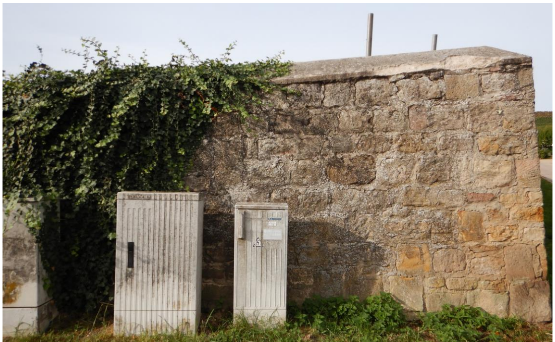
Abbildung 16: Aspekt der historischen Mauer, die das Untersuchungsgebiet im Süden begrenzt aus östlicher Richtung [Foto: BGNatur].
