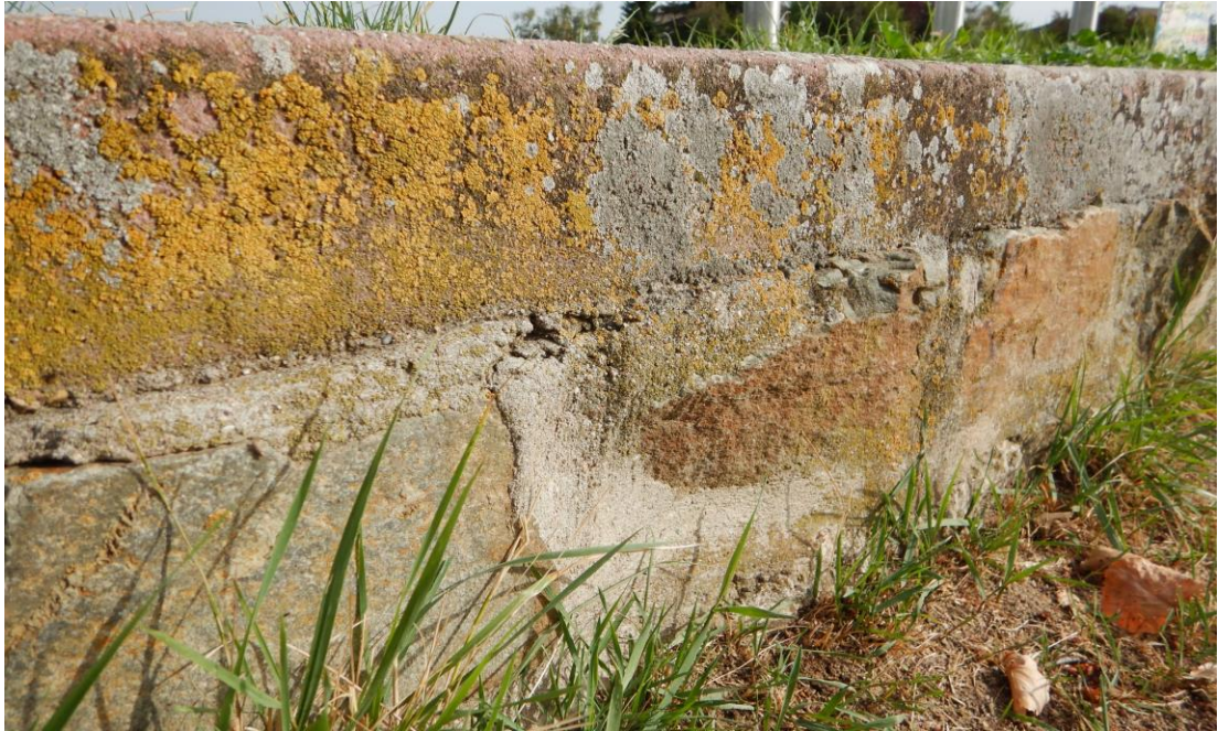
Abbildung 9: Aspekt der Mauer an der Straße „Am Reichsritterstift“ aus südwestlicher Richtung – Nahaufnahme der Fugen [Foto: BGNatur].
