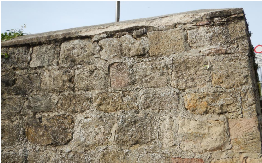
Abbildung 17: Aspekt der historischen Mauer, die das Untersuchungsgebiet im Süden begrenzt – Nahaufnahme der Fugen [Foto: BGNatur].
