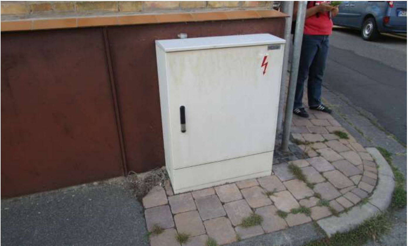
Abbildung 15: Stromverteilerkasten in der Bahnhofstraße
