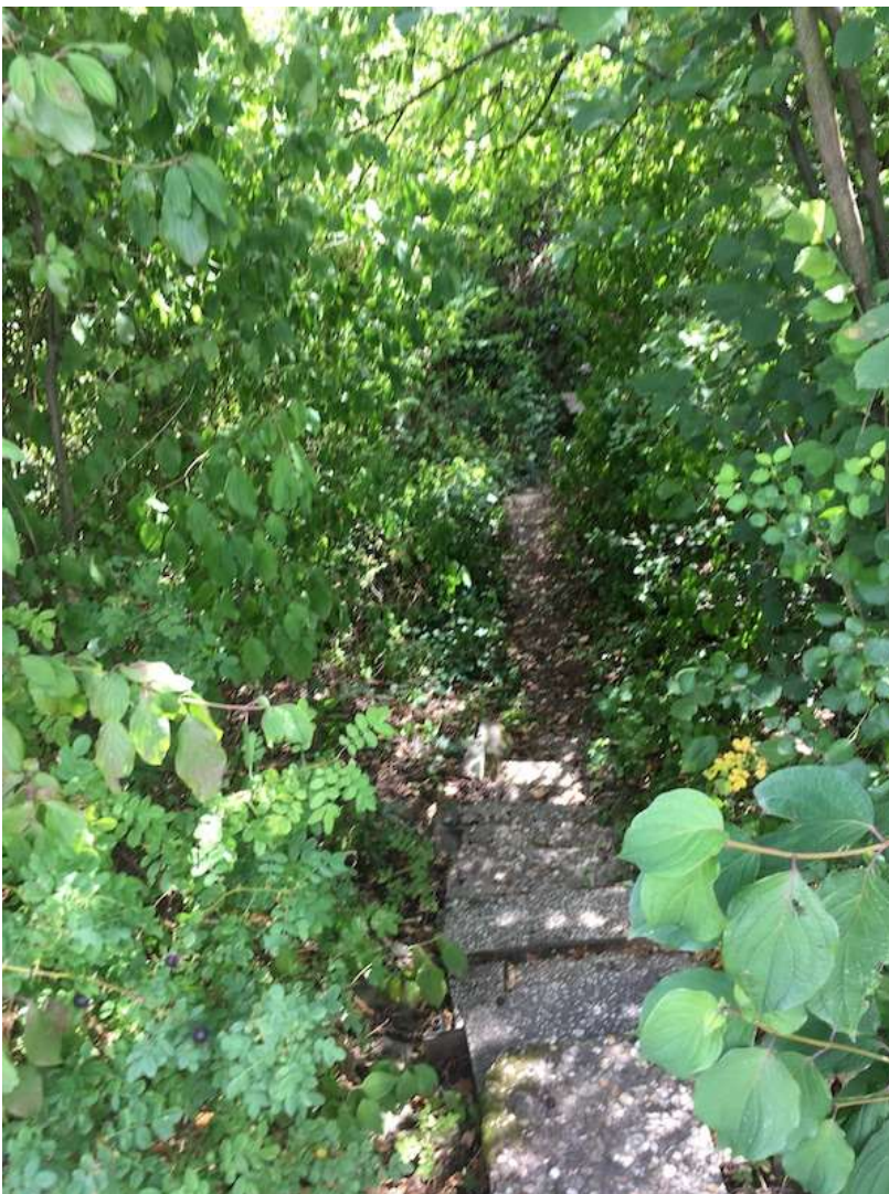
Abbildung 3: Zugewachsener Grabens zum Rückhaltebecken 231214-790_Harxheim_Manuskript_nachBIV.docx
