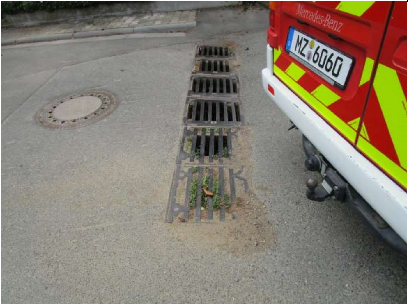
Abbildung 9: Zugesezte Schwerlastrinne am nördlichen Straßenende der Raiffeisenstraße
