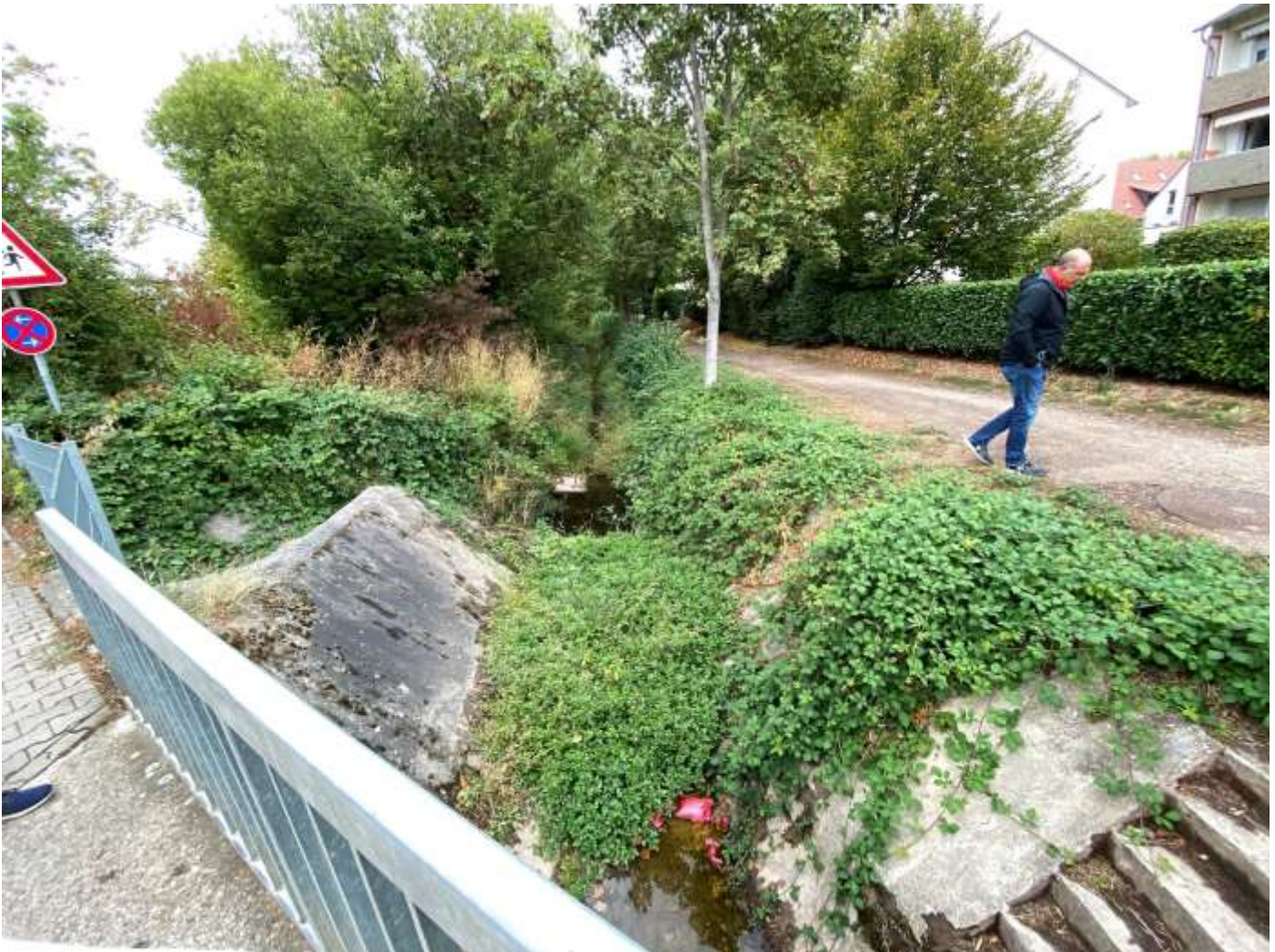
Abbildung 11: Schlammfang an der Pomnardstraße
